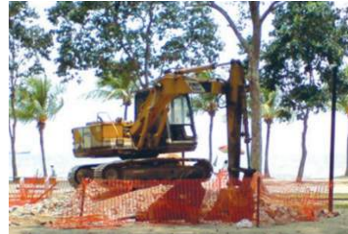
Hình 5.11: Che chắn khu vực đào bới bằng lưới cảnh báo và biển cảnh báo
